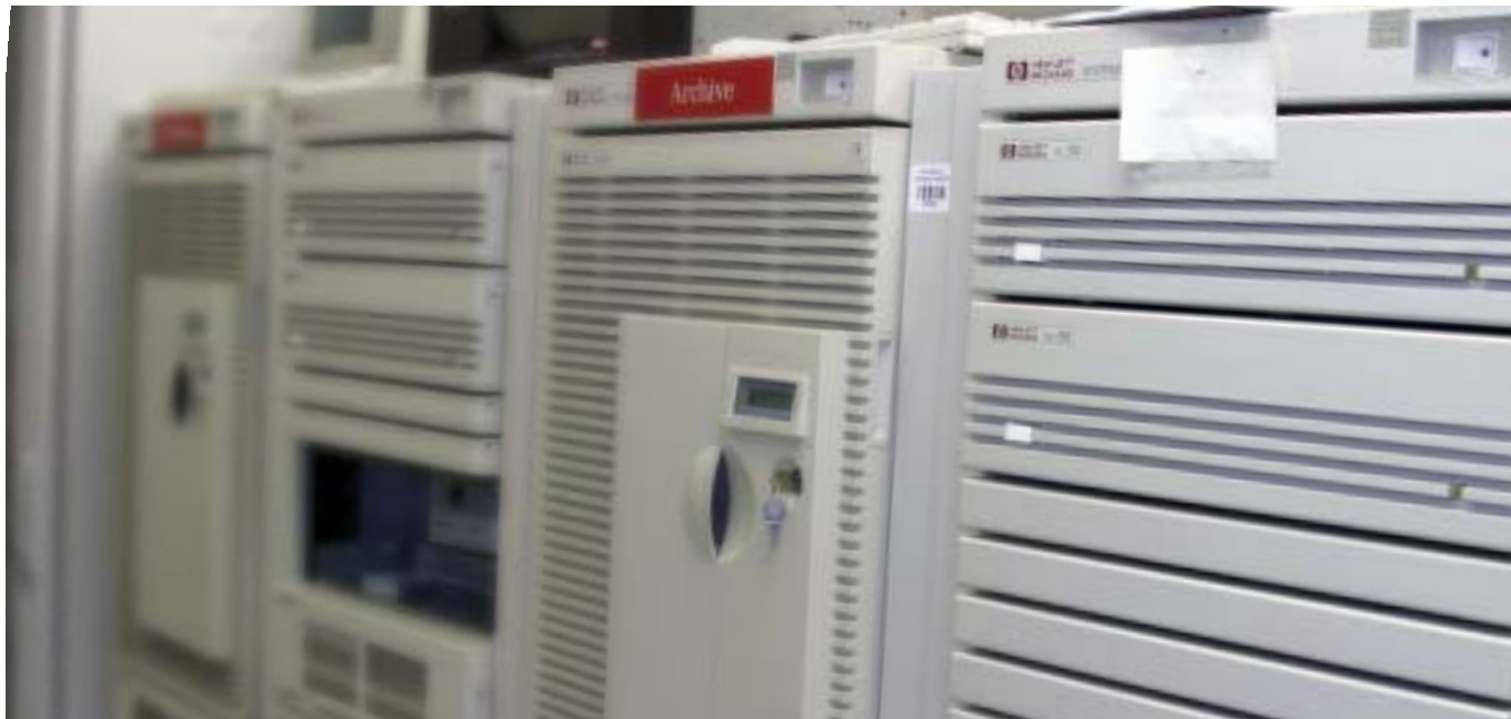
PHA Data Center
